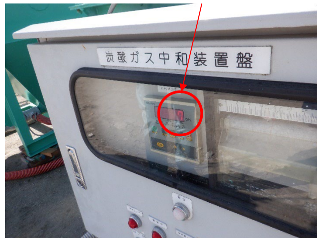
写真 4.5.2-2 中和処理装置
