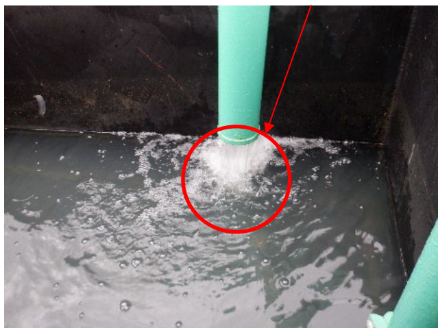
写真 4.5.2-1 放流口（放流水槽）の状況
